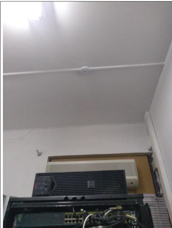
Fotografía N° 1 – Fotografía del detector de humo, en la Sala de Servidores, enviadas el 04-05-2020 vía correo electrónico por el Sr. [REDACTED], Encargado de la Seguridad de la información de la Municipalidad de Calama.
