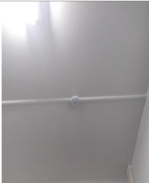
Fotografía N° 2 – Fotografía del detector de humo, en la Sala de Servidores, enviadas el 04-05-2020 vía correo electrónico por el Sr. [REDACTED] Encargado de la Seguridad de la información de la Municipalidad de Calama.
